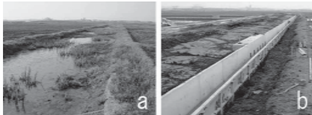
写真2 河北潟に近い金沢市木越地区の舟入川（河北潟に出るための舟運のための水路）の名残とその改修工事（a：2003年4月の状況、b：2006年3月改修中の状況。コンクリートユニットがはめ込まれている）
